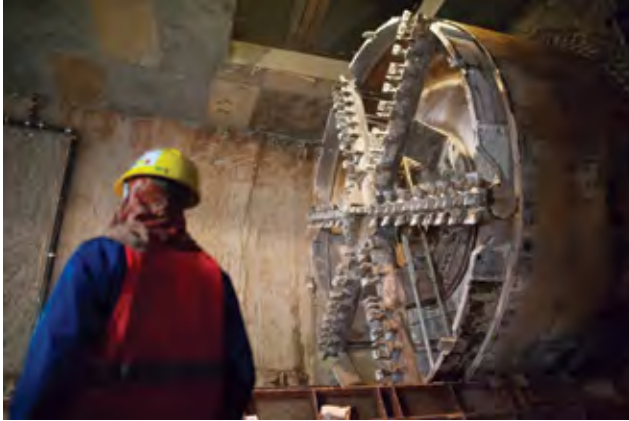
Satu dari empat Tunnel Boring Machine yang membuat terowongan MRT Jakarta Fase I, 20 Februari 2017. PT MRT JAKARTA/IRWAN CITRAJAYA.
